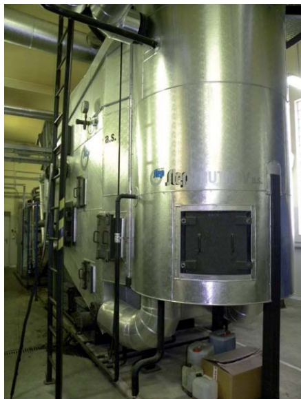
Větší ze dvou kotlů výtopny, který spaluje slámu zrnin nebo cíleně pěstovanou biomasu (energetický šťovík).
