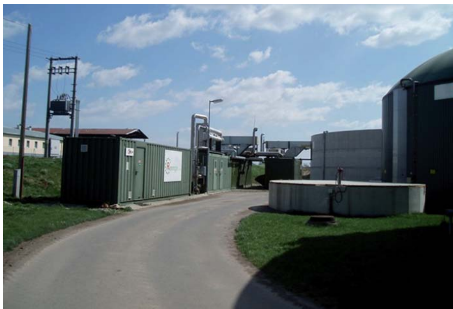
Stanice technologicky navazuje na provozy chovu prasat, které byly modernizovány v roce 2008 (foto: CZ Biom).
