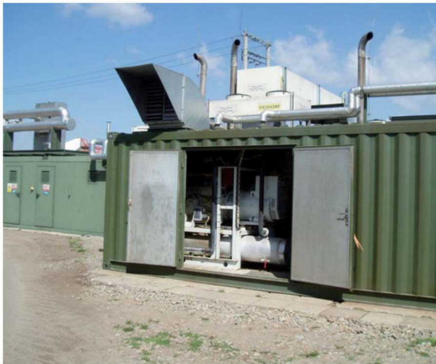
Tři kogenerační jednotky jsou umístěny v mobilním kontejneru. BPS má roční produkci 4 300 MWh elektřiny a 5 290 MWh tepla (foto: CZ Biom).
