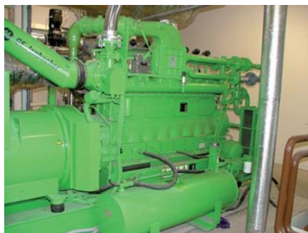
Kogenerační jednotka na bioplynové stanici v Kněžicích vyrobí za rok celkem 2 600 MWh elektrické energie. Z toho 2 200 MWh je dodáno do elektrizační soustavy.
