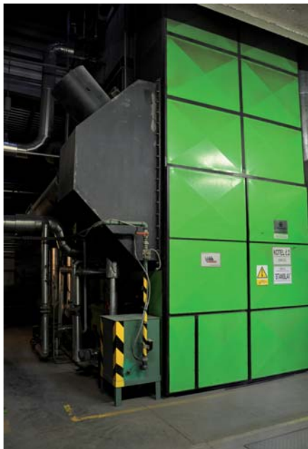
Dva horkovodní kotle mají jmenovitý tepelný výkon 4,5 MW a ročně spálí přibližně 47 tis. m 3 štěpky.
