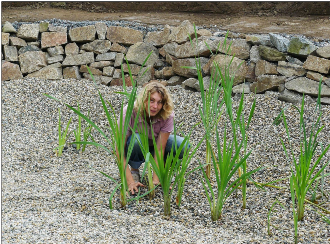
Kořenová čistírna odpadní vody funguje na principech šetrných k přírodě a zároveň může díky mokřadním rostlinám působit vkusným dojmem.
