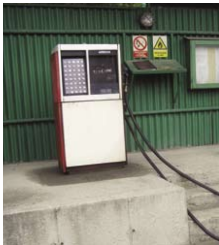
Čerpací stanice pohonných hmot vhodně zabezpečená proti únikům ropných látek i vlivu srážkových vod
